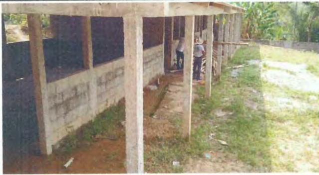
Foto 1: Se observa la falta de piso y alisado del corredor para mejorar las instalaciones del módulo 2
