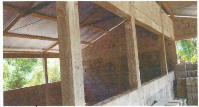
Foto 2: Se ve la falta de ventanas de las tres aulas del módulo 2
