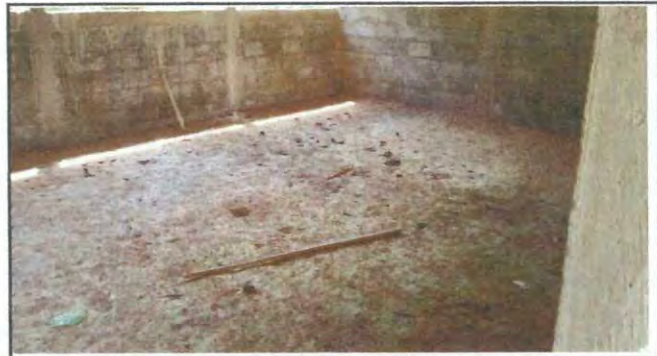
Foto 4: Se observa la falta de piso de cemento del aula 3 del módulo 2, la cual es necesario mejorar.
