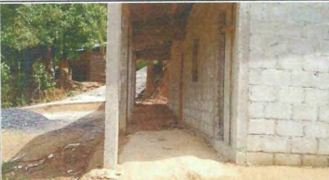
Foto 3: Se observa la falta de piso del corredor, ventanas, repello de la dirección y bodega del módulo 1.
